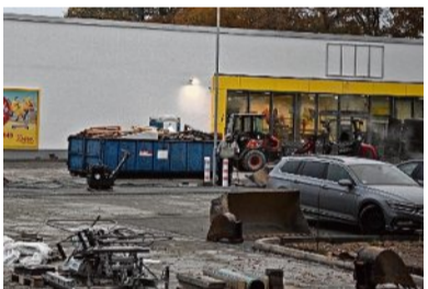
Der Löwenanteil ist geschafft. Vor der Eröffnung des Netto-Marktes in Selsingen gibt es noch letzte Arbeiten zu erledigen, damit bis dahin alles fertig ist. Foto: zz/Hilken
